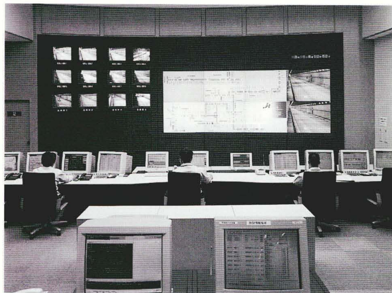
図1 日本道路公団名古屋管理局施設制御室
