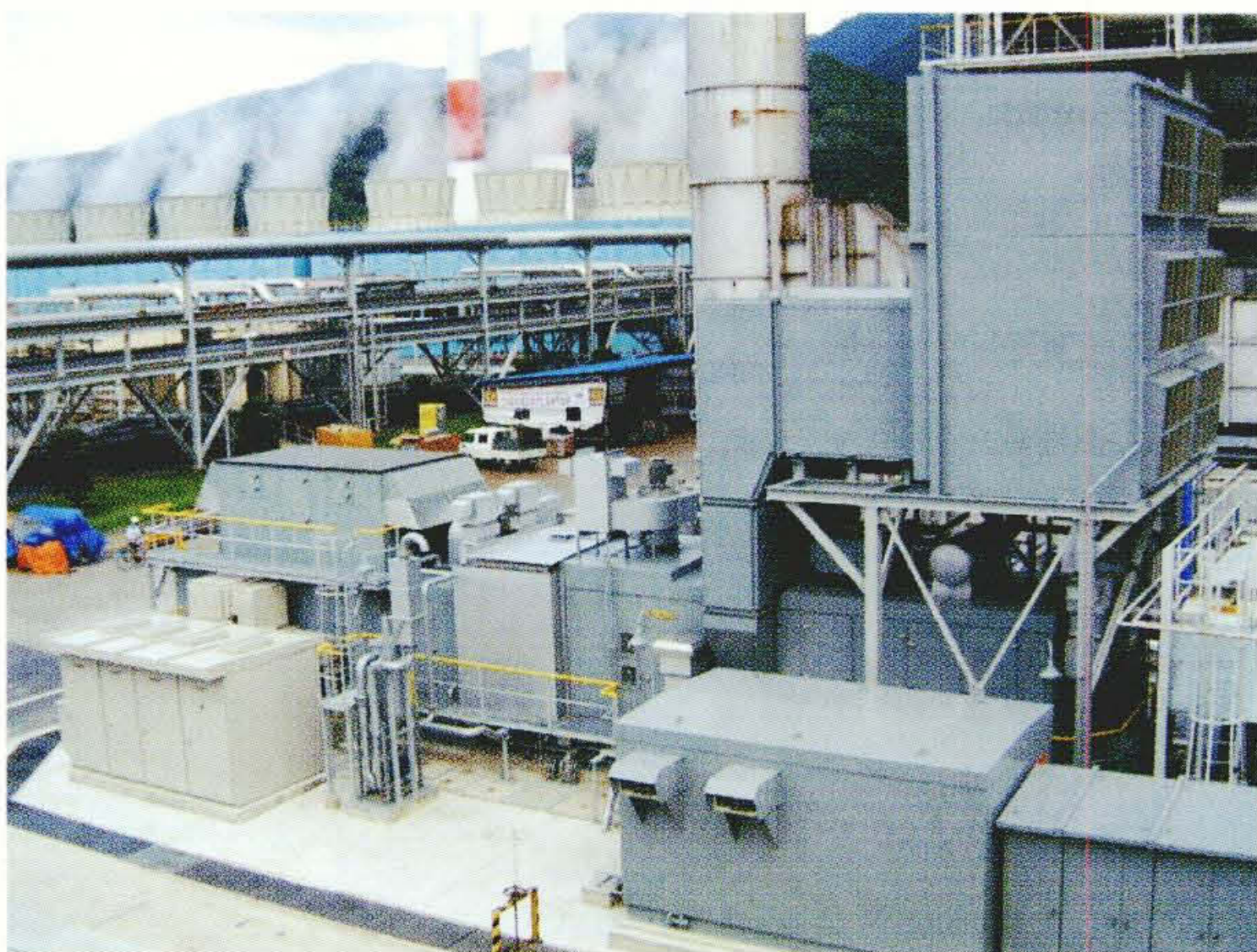
韓国LGPC社Yosu工場納めNo.2ガスタービン
