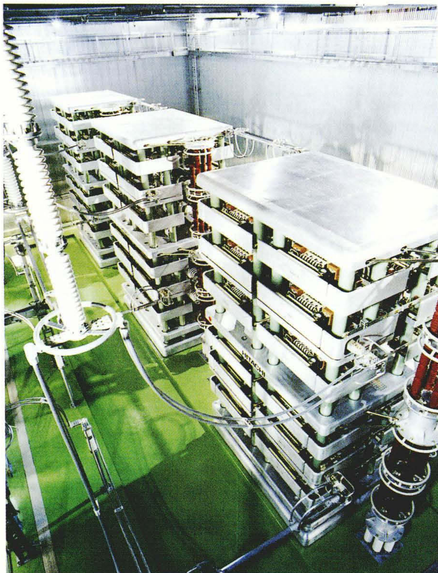
大容量化・コンパクト化（体積容量比：60%）を図った700 MWサイリスタバルブ（250 kV 2,800 A、4アーム積層）
