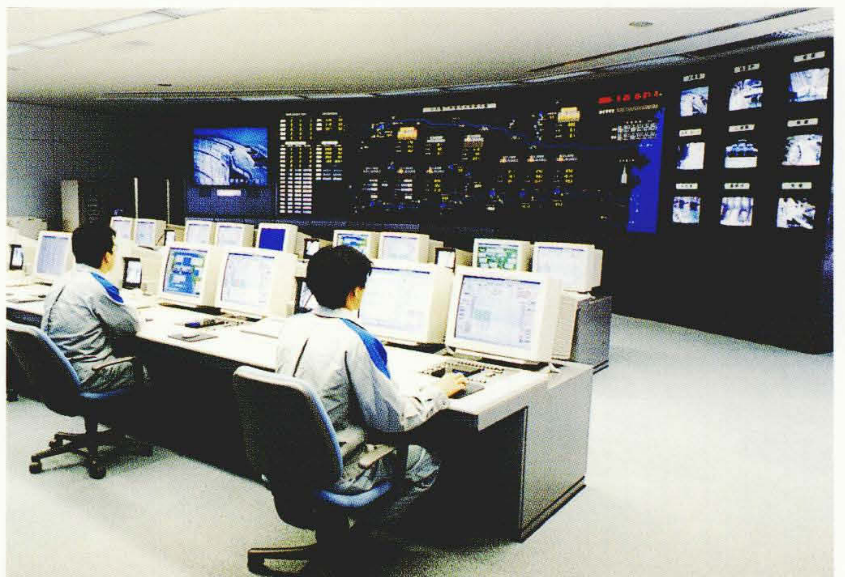
九州電力株式会社日向電力所納めダム総合管理システム
