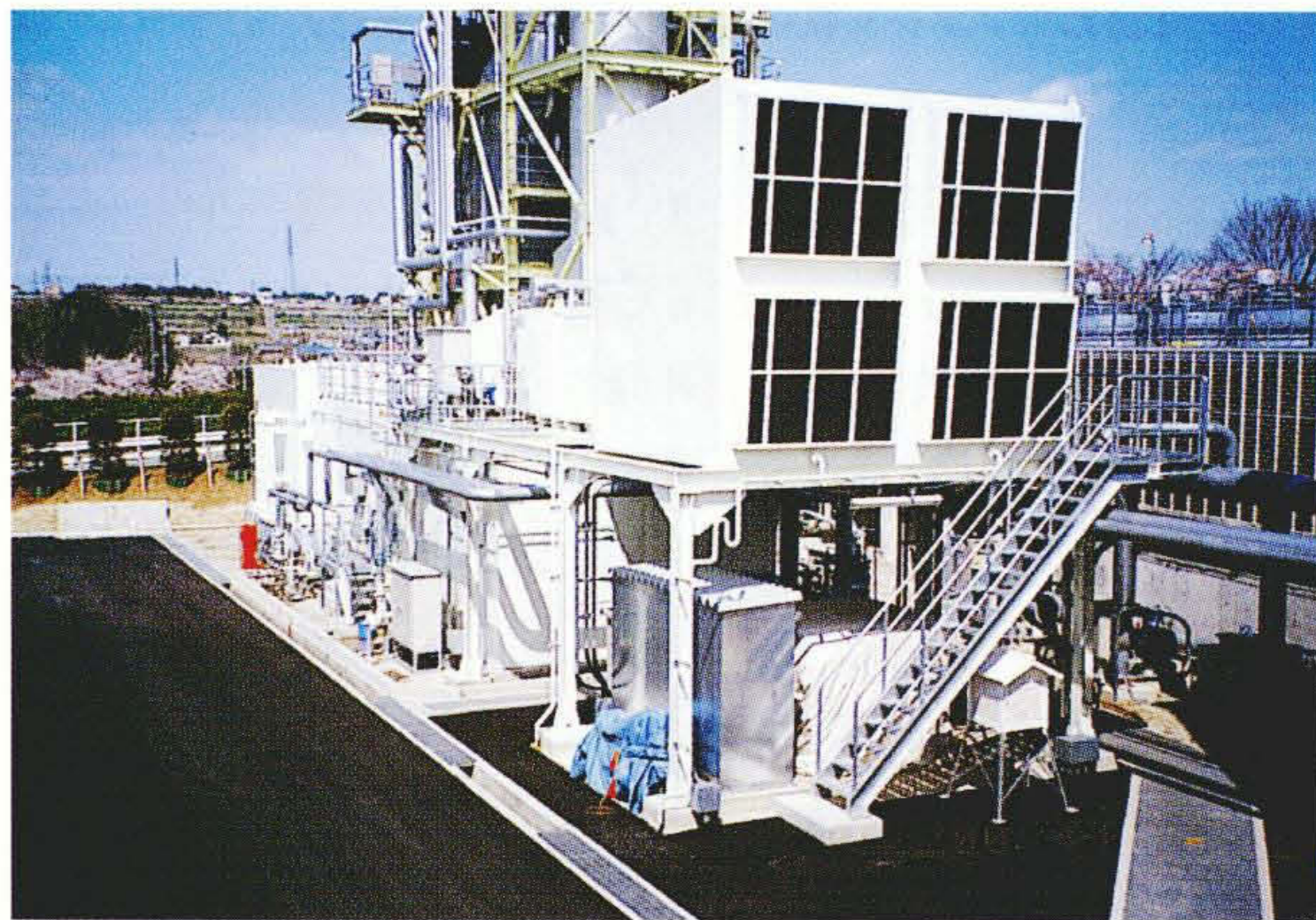
トヨタ自動車株式会社三好工場第2発電所納め コンバインドサイクル発電設備ガスタービンの外観
