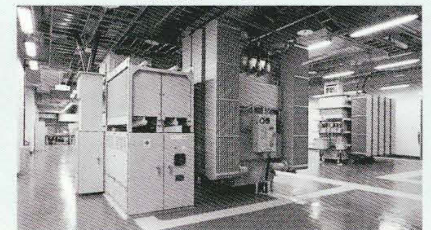
直流変電システム
