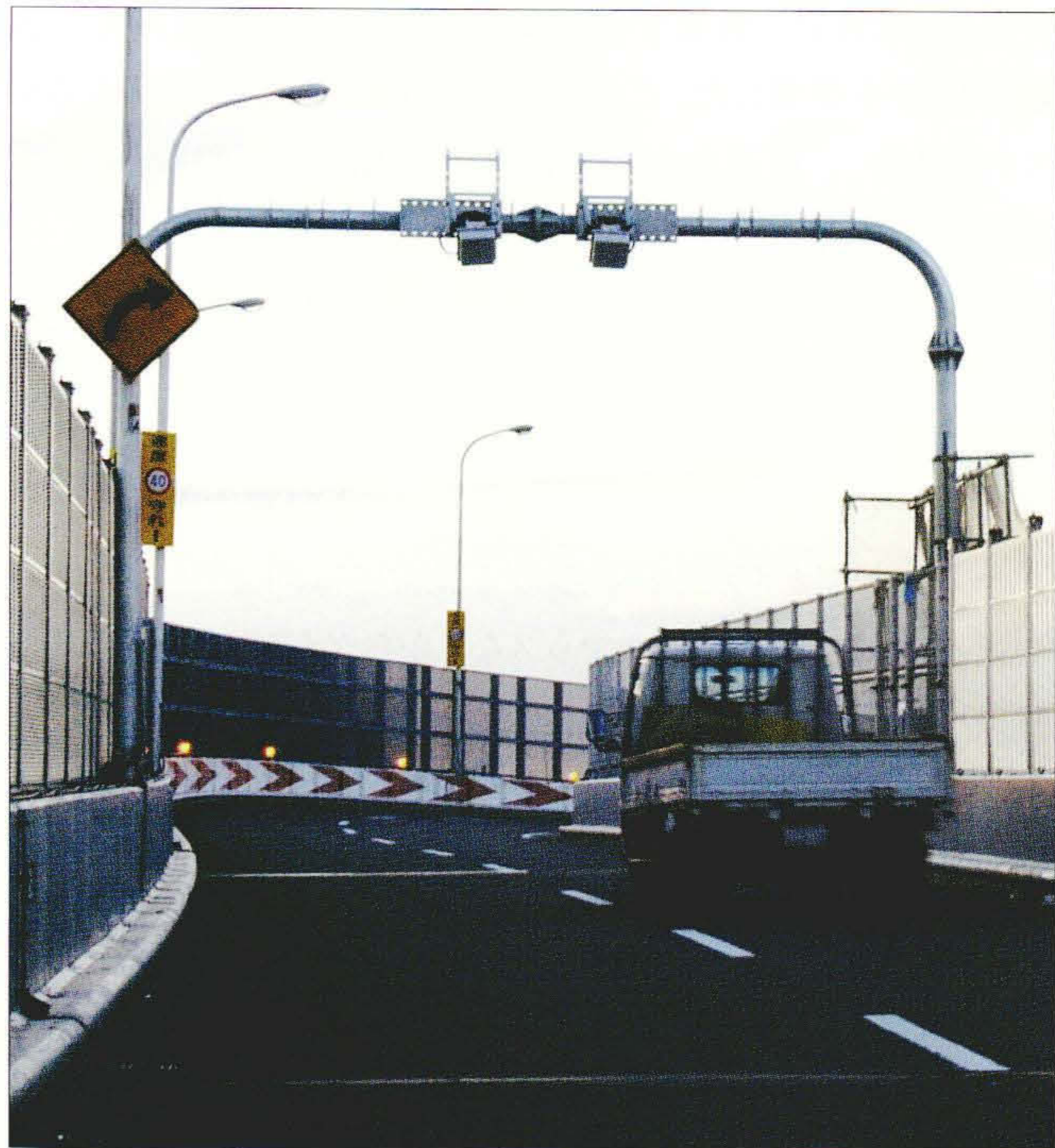
出口車線のフリーフローETC用アンテナ
