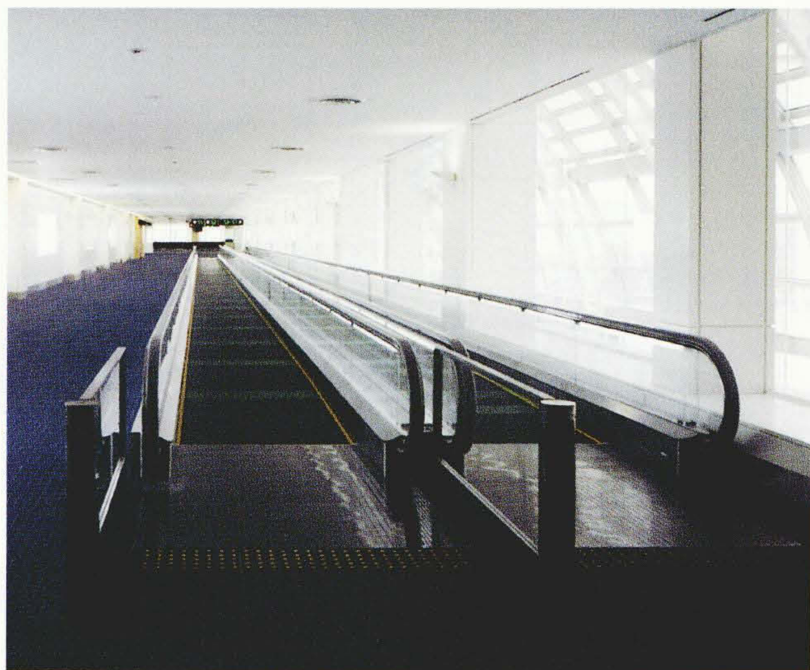
羽田空港・東旅客ターミナルビル納め超薄型動く歩道「オートライン」の外観
