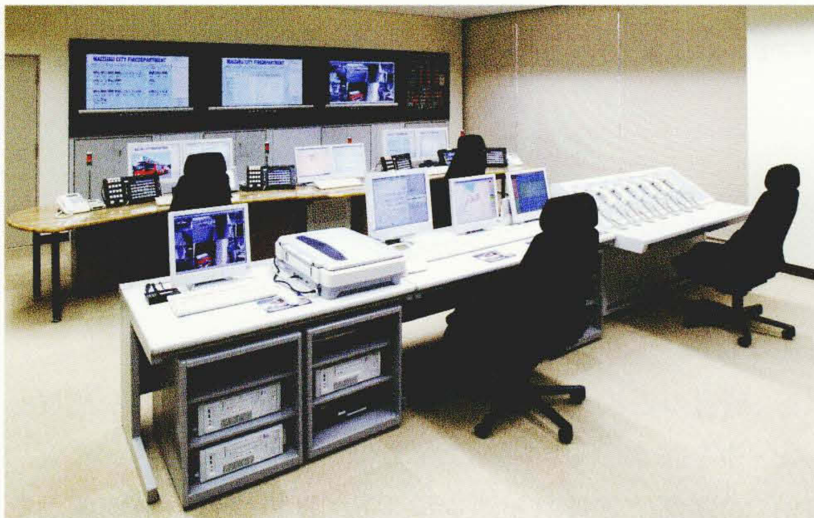
舞鶴市消防本部災害情報室の消防緊急通信指令システム
