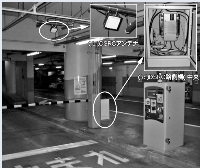
(a) 設置状況(出口)
