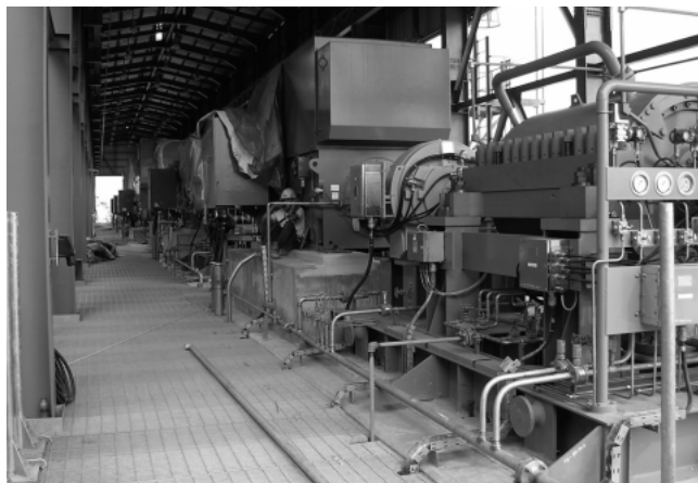
図4 5,800 kW電動機駆動製品ガス圧縮機の外観 ベタラ ガス プラントに設置された製品ガス圧縮機の外観を示す。
