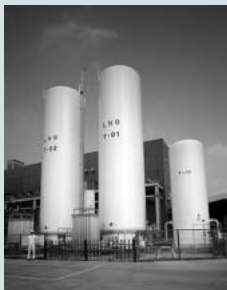
LNGサテライト設備
