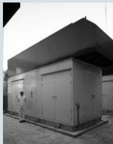
ガスエンジンコージェネレーション設備
