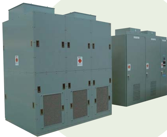
2,000 kVA 高圧ダイレクトインバータ装置
