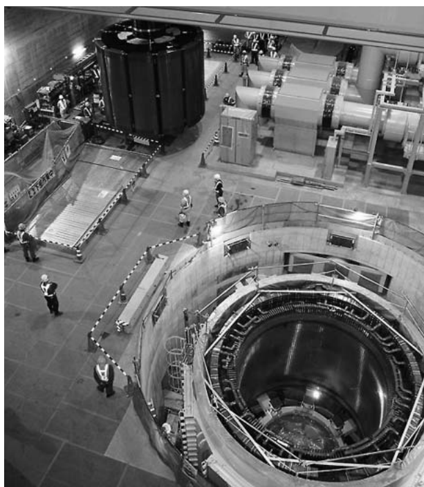
図3 発電電動機の固定子および回転子 発電所現地における固定子への回転子つり込み前の状況を示す。
