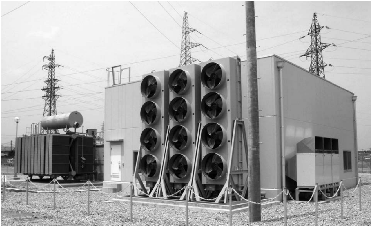
図1 北陸電力株式会社伏木変電所納め 20 MVA STATCOMの外観
