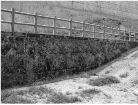
図13 道路擁護壁ブロックの施工例 植物が活着しやすい環境に配慮した製品である。
