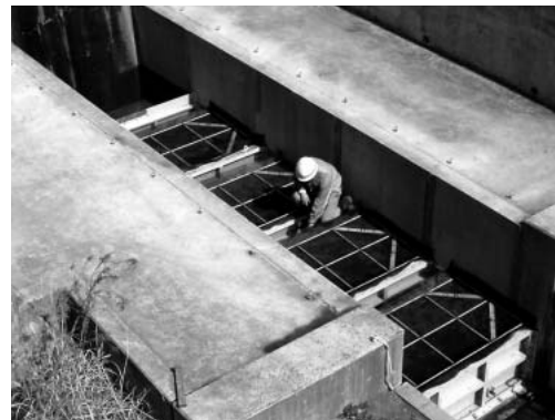
図11 射撃場の鉛排水浄化設備
