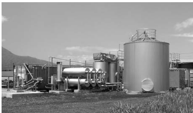
図4 実証実験プラントの外観 1日の処理量が5 m 3 の規模で実証実験を行った。
