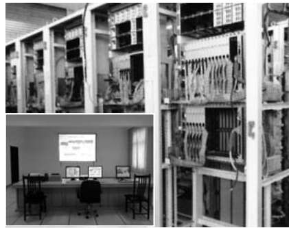
図10 北京日立制御システム有限公司(BHC)の上下水監視制御システム 上下水監視制御システム製造拠点として,中国の水環境インフラ整備に貢献している。
