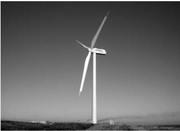
図11 風力発電設備 2,000 kWダウンウインド方式風力発電設備の設置例を示す。
