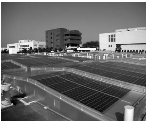
図10 片面受光太陽光発電設備
