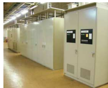
図5 蓄電池式回生電力吸収装置 地上変電所の蓄電池式回生電力吸収装置により、供給電圧の安定化や回生効率の向上などを図る。
