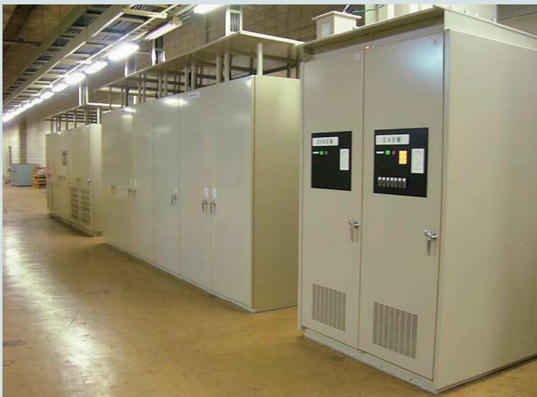
図1 稼働開始した蓄電池式回生電力吸収装置の外観
