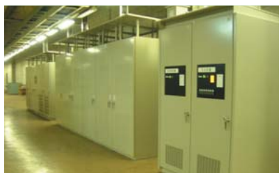
4 電鉄変電所に設置された再生電力吸収装置
