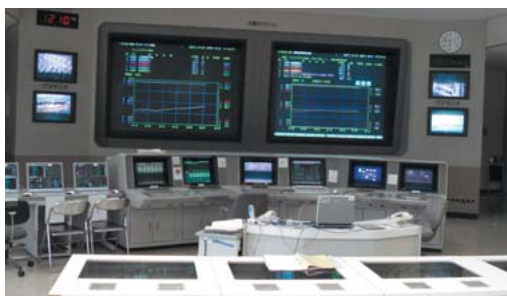
3 中国電力株式会社柳井発電所計算機
