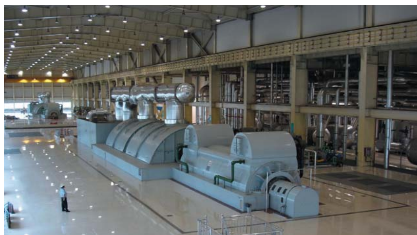
8 中華人民共和国山東省鄒県発電所のタービン発電設備（手前：7号機、奥側：8号機）
