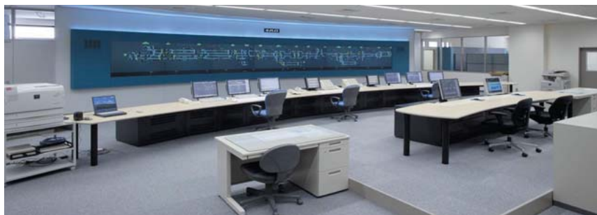
7 運行管理システム運転指令室
