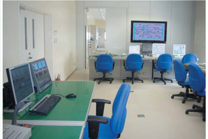
9 親松排水機場中央監視装置
