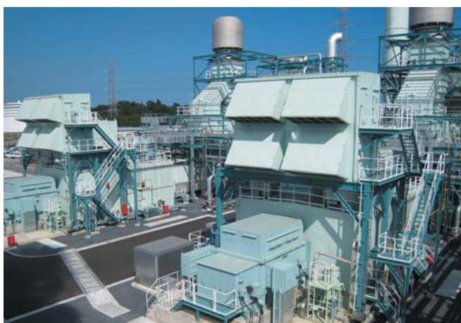
4 新日本石油精製株式会社仙台製油所の100 MW級H-25ガスタービン高効率複合発電設備
