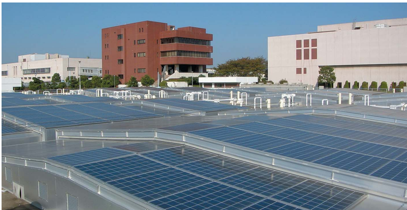
6 覆蓋上部に設置した太陽光発電システム
