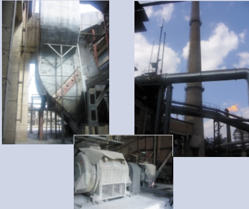
発電用ボイラ 誘引ファン、押込ファン
