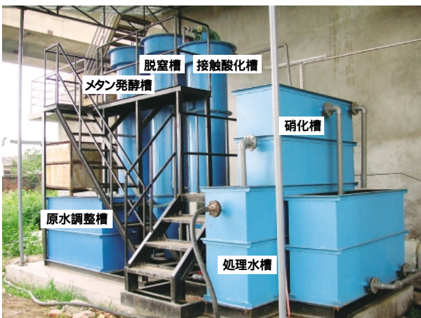
図5 高濃度アンモニア廃水処理パイロット装置 メタン発酵 脱窒 接触酸化 硝化の処理フローで構成する処理規模600 L/日の装置の外観を示す。
