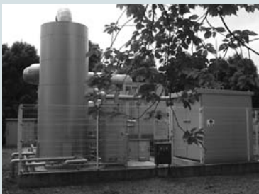
建物横に設置されたディーゼルエンジンコージェネレーション設備
