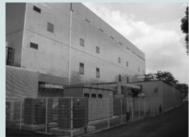
高効率トランスを含む受変電設備
