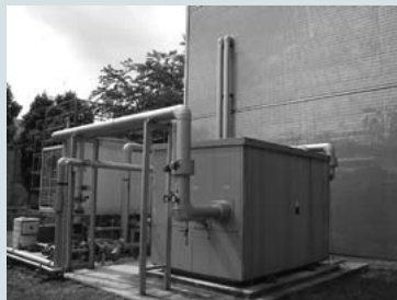
コージェネレーション設備で生成された冷水は、コンピュータビルへと送水され、サーバ室の冷却に使用される。
