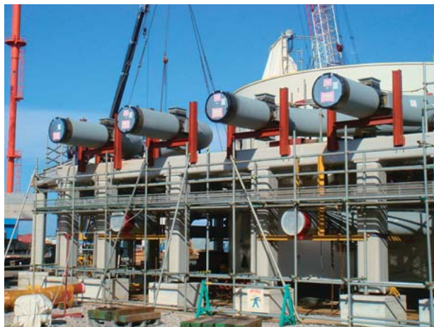
図2 RCCV内(上部ドライウェル)モジュール
