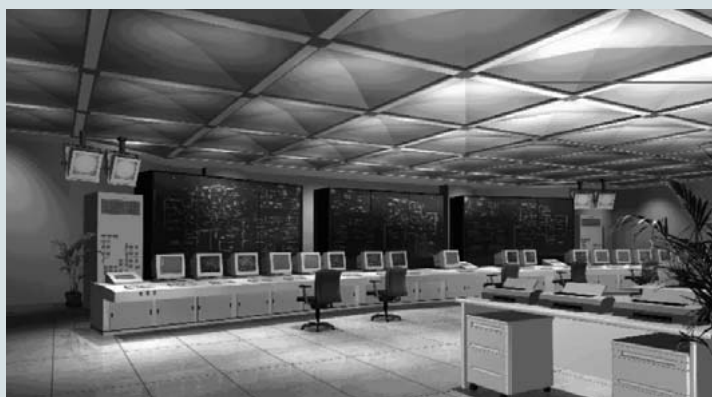
図1 発電所の集中監視室
