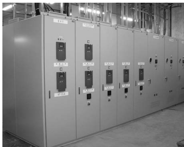
図7 固体絶縁母線スイッチギヤの外観 新幹線中間配電所での据付けの様子である。
