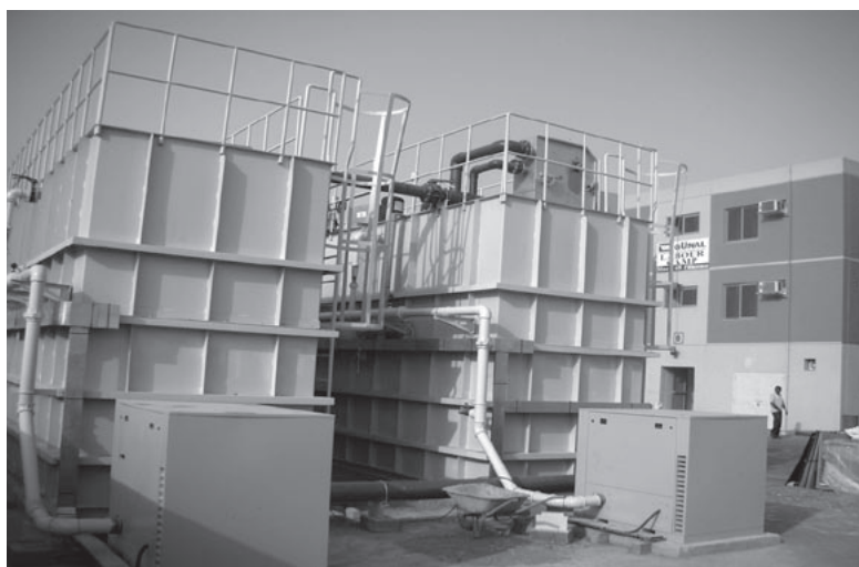
図6 中東・ドバイに納入したMBR (Membrane Bio-reactor) システム レイバーキャンプの生活排水処理・再生を主目的とし、処理規模は500 m 3 /日×2台である。
