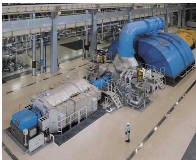
2 電源開発株式会社磯子火力発電所蒸気タービン
