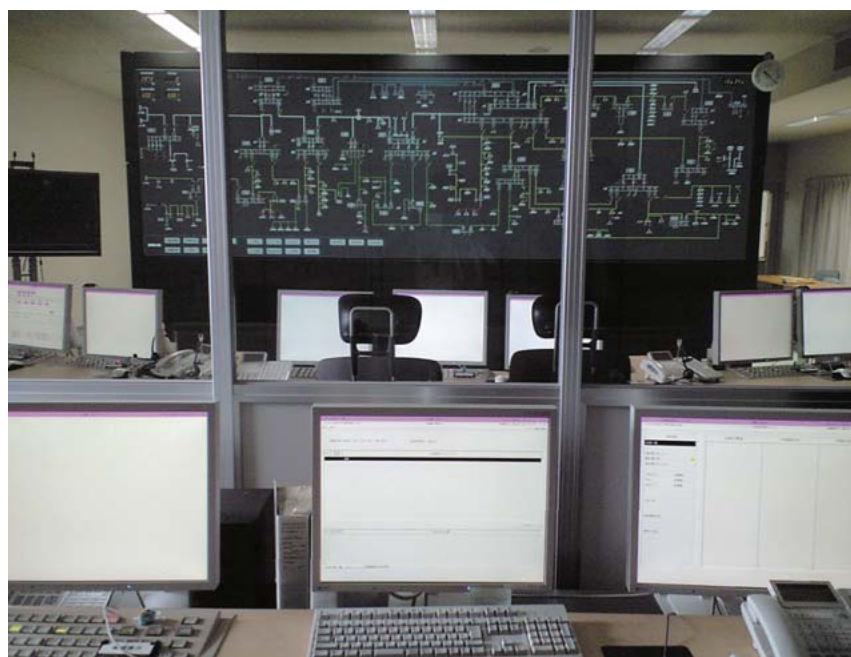
2 松本給電制御所の訓練装置
