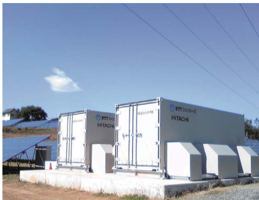
5 屋外設置したパワーコンディショナ（コンテナ1個に2台収納）
