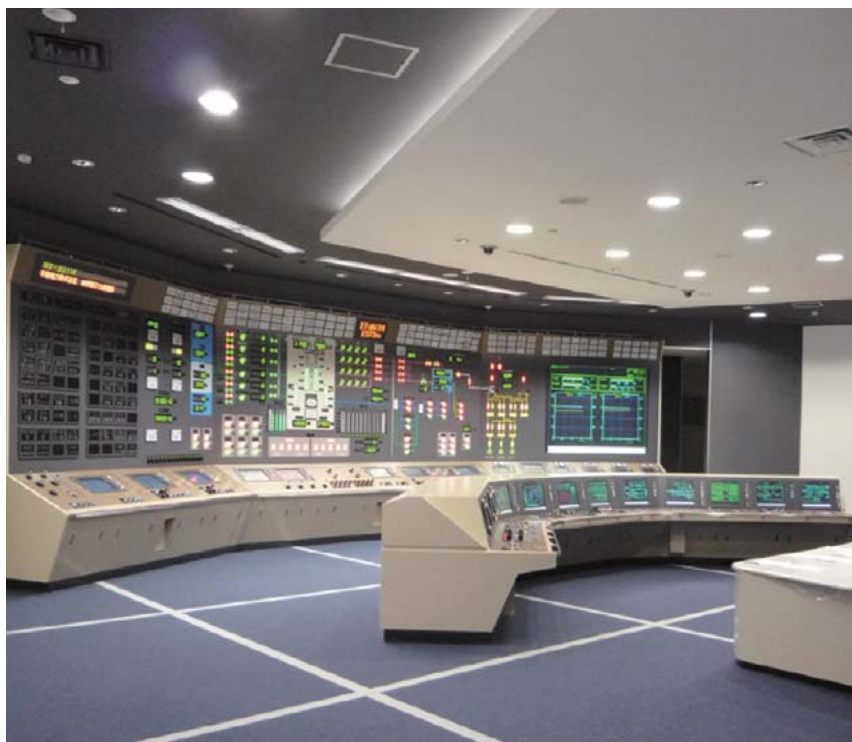
2 島根原子力発電所3号機運転訓練用フルスコープシミュレータの全景
