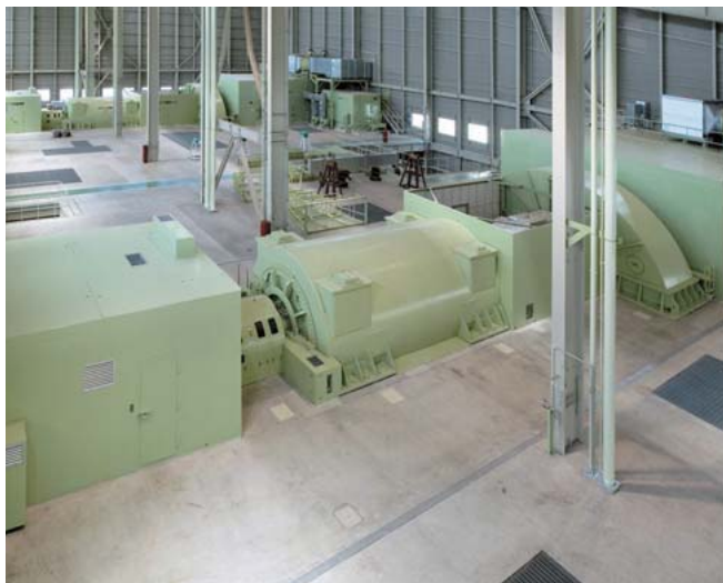
3 大阪ガス株式会社泉北天然ガス発電所パワートレイン
