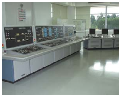
2 九十九里地域水道企業団東金浄水場監視制御システム
