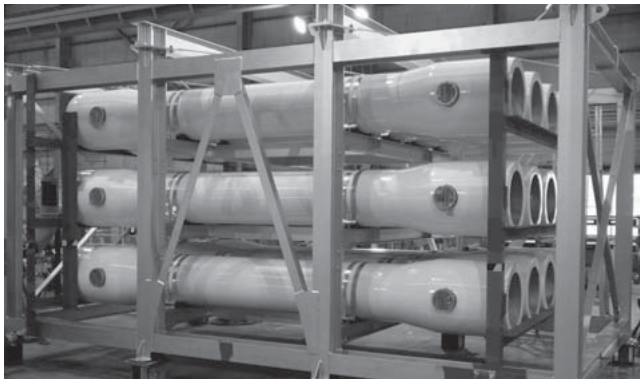
図6 | 大型RO膜実験ユニット
