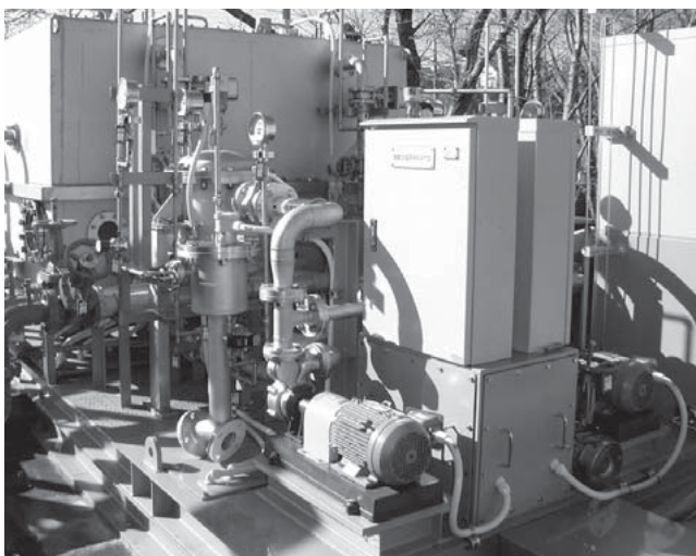
図4 | オゾンマイクロバブル水再生装置 (600 m 3 /日) 外観 オゾン反応槽はマイクロバブルの流動特性をモデル化した流体解析を行い、設計を最適化した。
