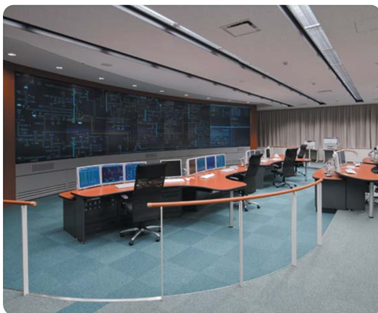
5 九州電力 北九州電力センター総合制御所(当直運転室)
