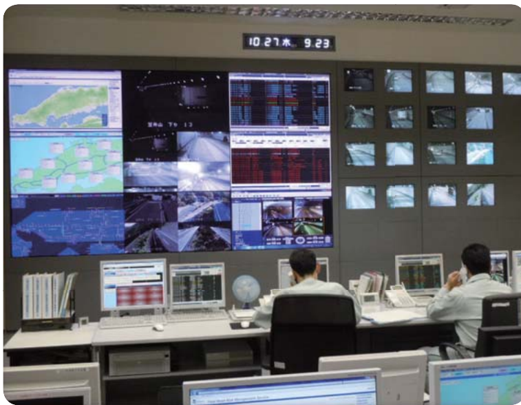
1 西日本高速道路中国支社 施設制御局中央システム
