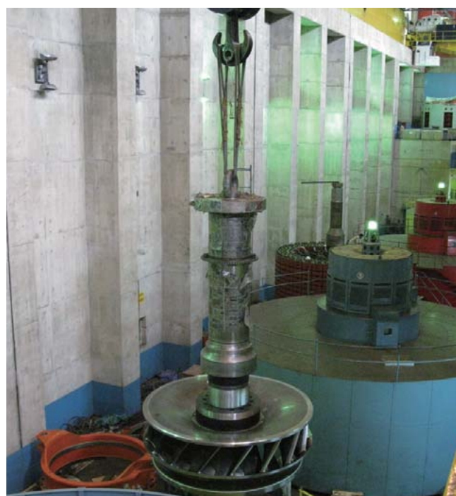
1 インド・パークラ発電所 128 MWフランス水車
