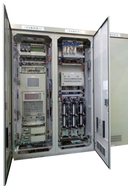
2 電源開発 沼原発電所1号自動制御装置
