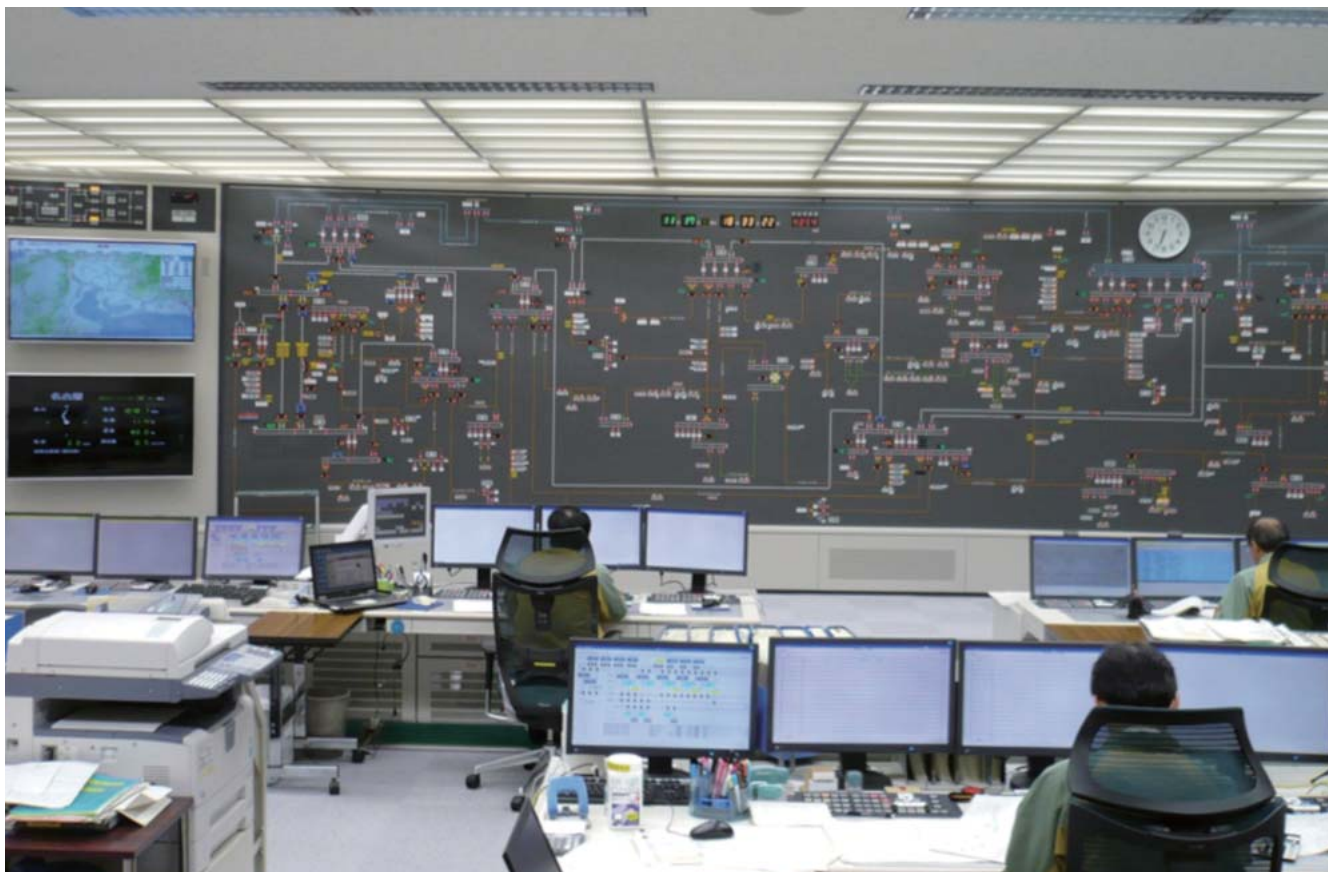
1 中部電力 名北給電制御所
