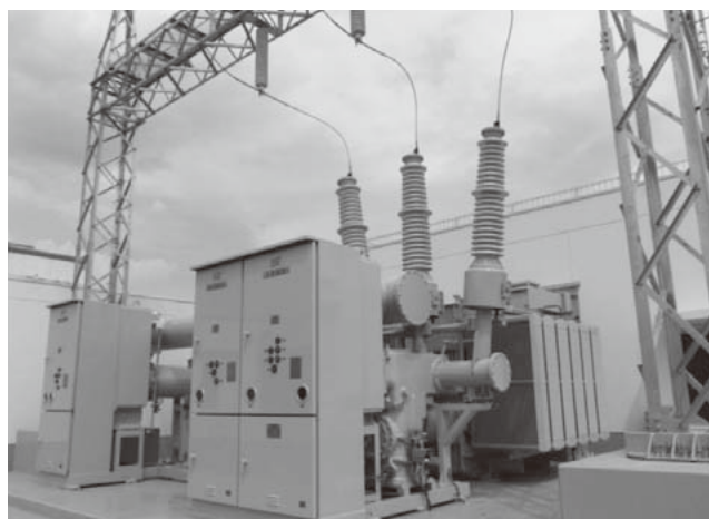
図4 | 本復旧後の特別高圧受変電設備(GIS)
