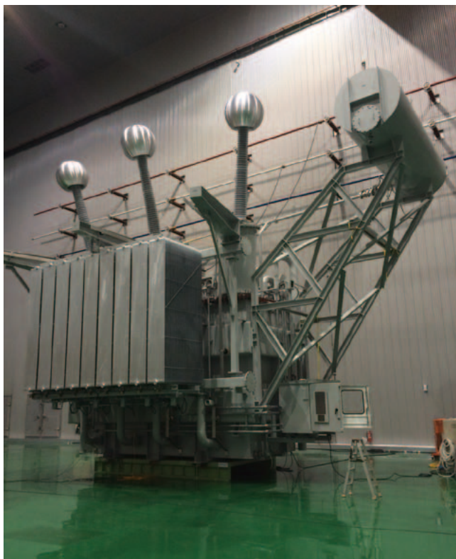
6 345 kV 265 MVA発電所用変圧器の外観
