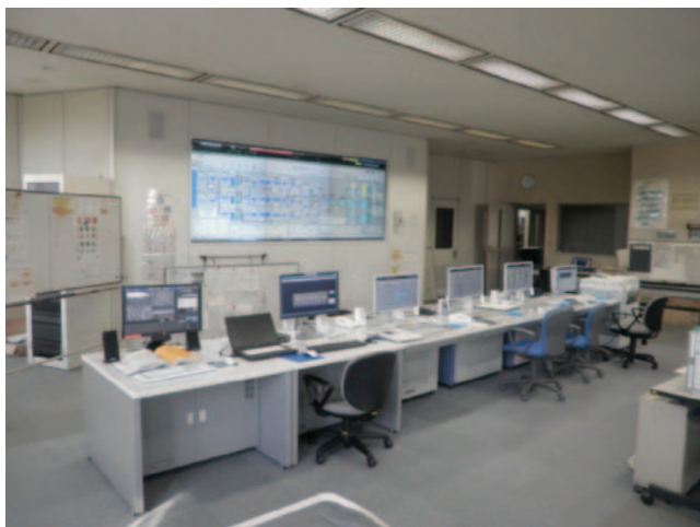
4 大阪市水道局庭窪浄水場 監視制御システムの中央監視室
